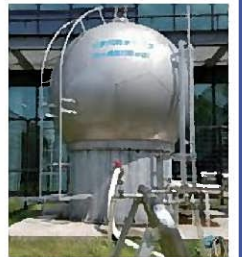
災害用給水タンク(熊本市)
